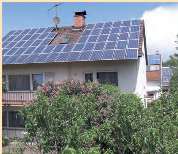
Privates Wohngebäude mit einer 6 kW-PV-Anlage
