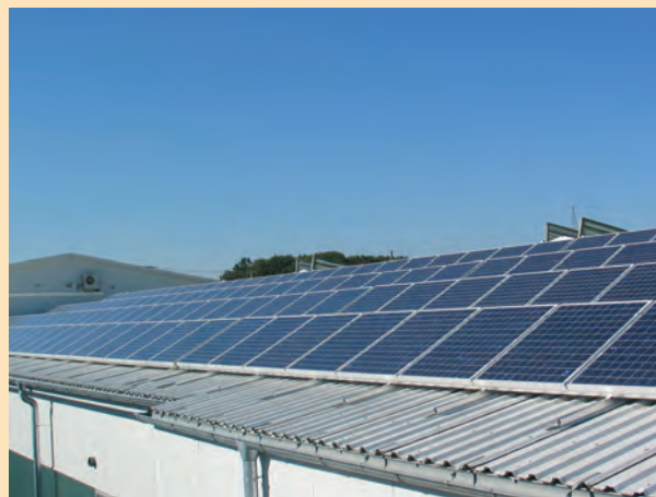
Gewerbegebäude mit Solarkraftwerk, 30 kW
