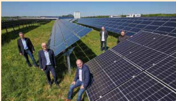
Erweiterung Solarpark Langenried, 750 kW
