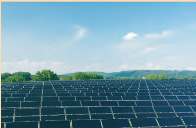
PV auf einer ehemaligen Mülldeponie | Solarpark Rickelshausen
