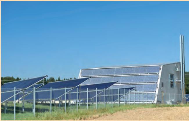
Heizzentrale und Solarthermie im Bioenergieort Büsingen
